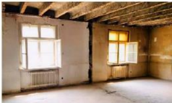
Haydnplatz 5: Die ausgehöhlten Zimmer waren jahrelang in diesem Zustand. Endlich wird mit der Sanierung begonnen. Foto: privat
