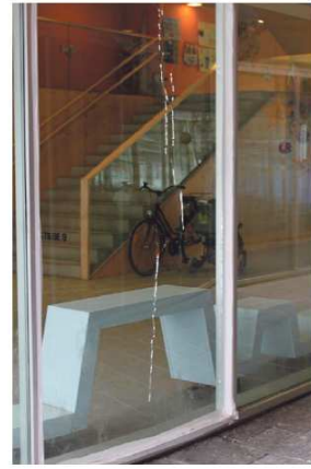
Erst vergangene Woche mussten Glasscheiben repariert werden.
