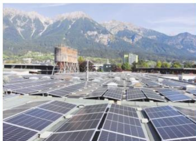
Insgesamt 6380 m 2 Photovoltaikfläche stehen nun am Betriebsareal der Innsbrucker Immobiliengesellschaft in der Rossau bereit. Foto: Michael Domanig
